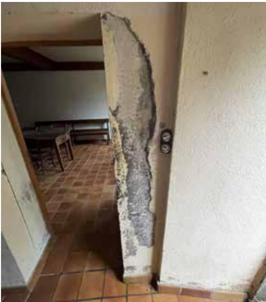
Décollement d'enduit ciment RDC
