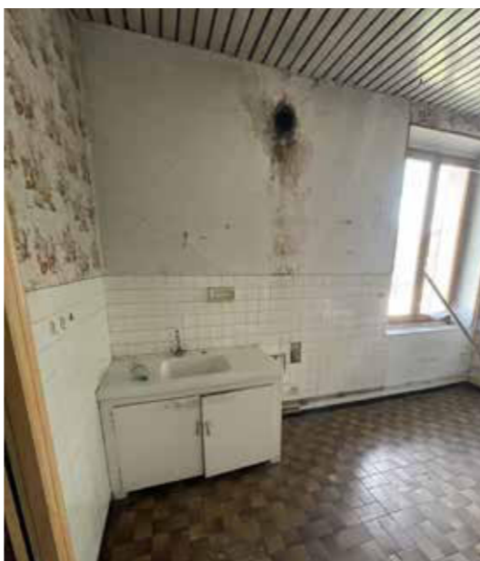
Traces d'humidité cuisine logement Nord
