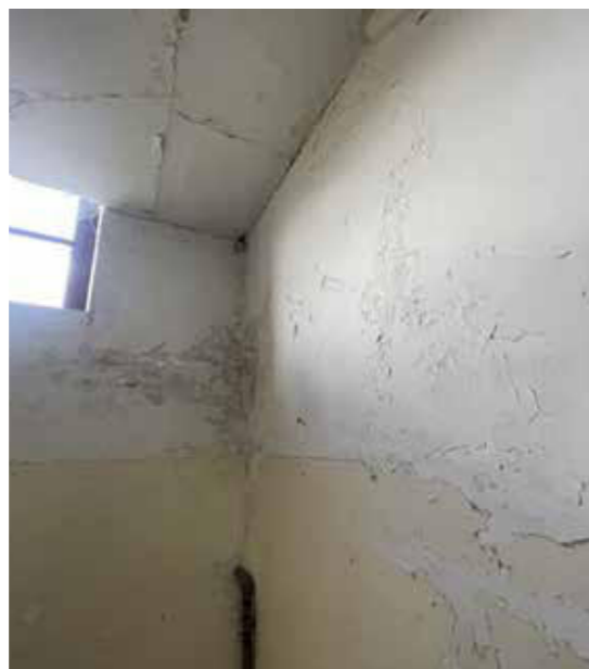
Traces d'humidité cage d'escalier
