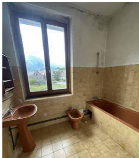
Traces d'humidité salle de bain logement Nord
