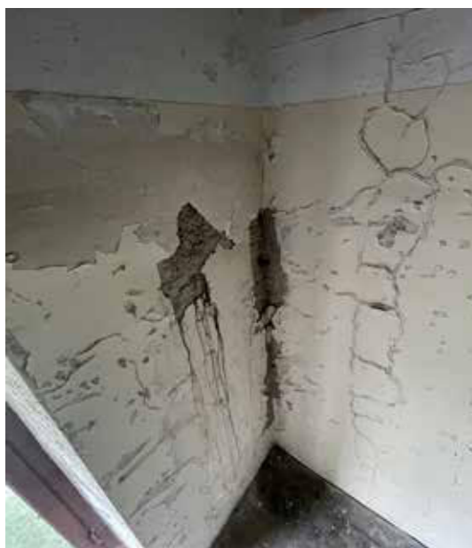
Décollement d'enduit cage d'escalier
