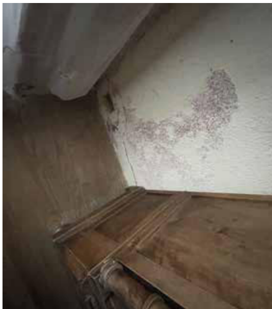
Fissure mur Ouest r+1
