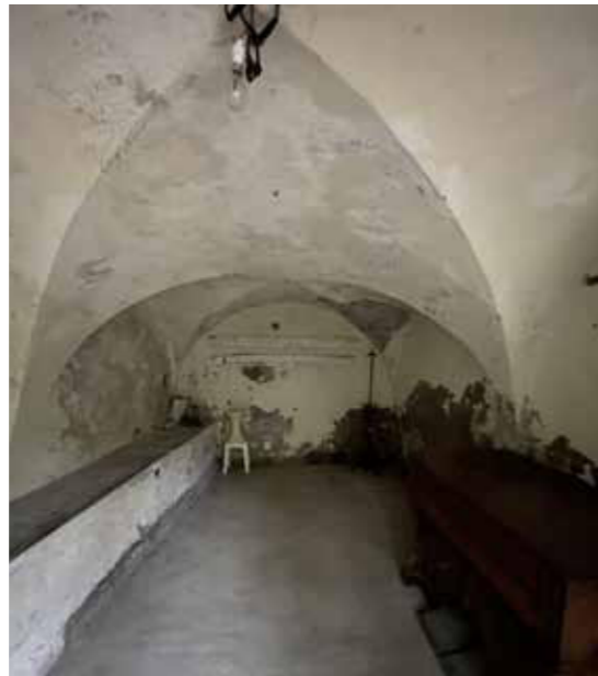
Traces d'humidité voûte d'arrête RDC
