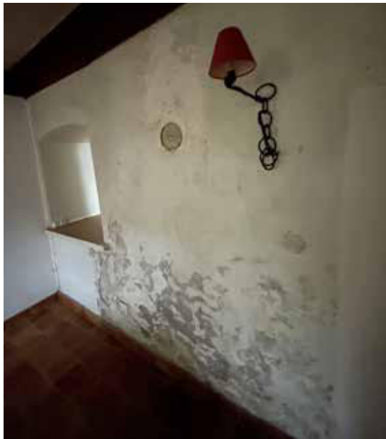
Traces d'humidité dans le mur de refend RDC
