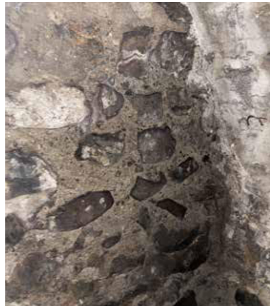
Traces d'humidité voûte arrière RDC
