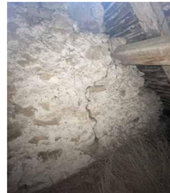
Fissure mur Est combles
